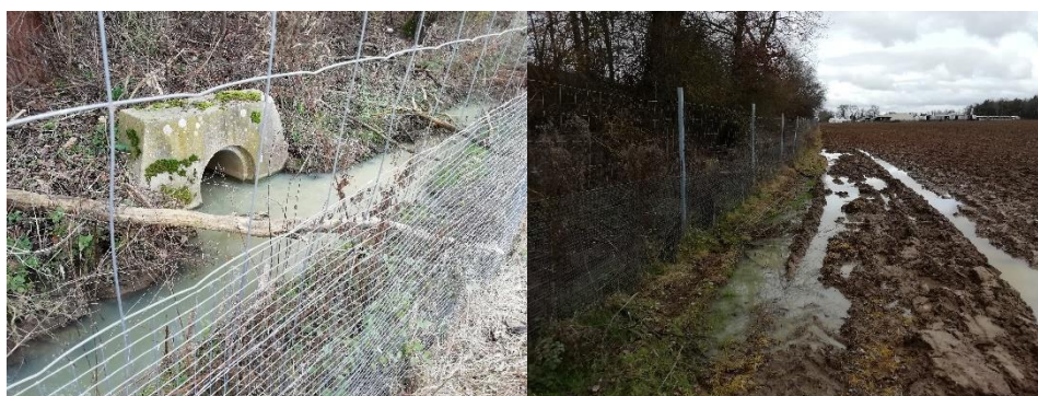
Figure 6: Dysfonctionnement de l'ouvrage hydraulique (source : Sanef)
